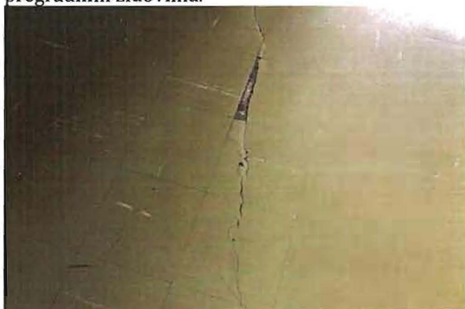
Slika 1. Karakteristično oštećenje: Pukotine u međuspratnoj konstrukciji.
